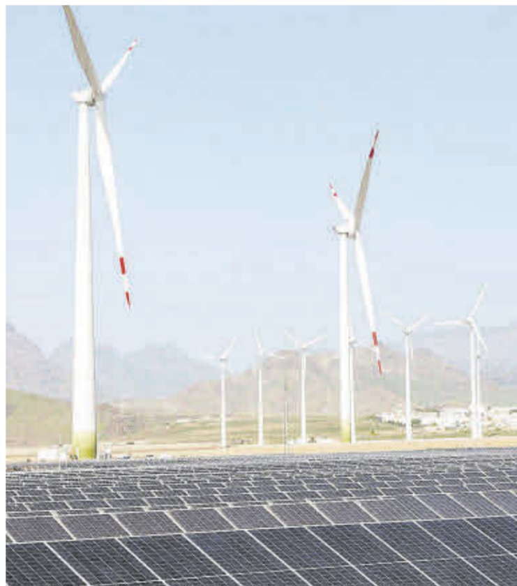
Aerogeneradors i plaques solars instal·lats a Gran Canària.
