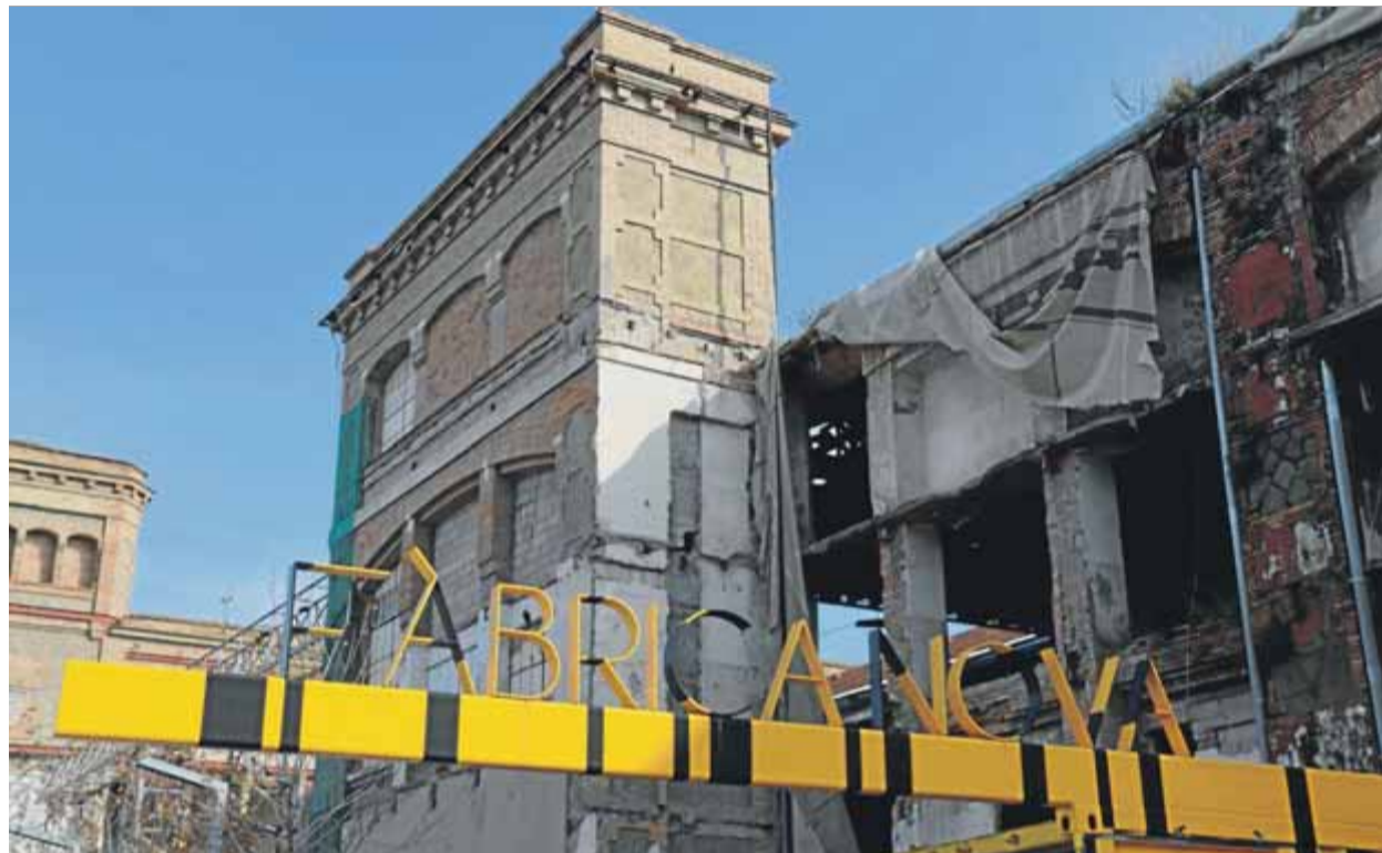
L'exterior de la Fàbrica Nova de Manresa, on ja han començat les obres que l'han de tornar a la vida ■ ACN
